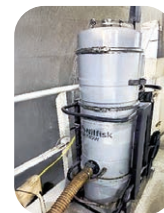
除塵系統 Dust collection system
